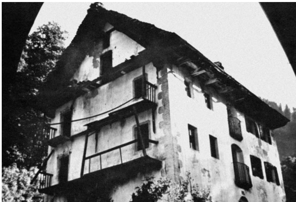
La Čè di Canònigh già pericolante, prima del 1962, anno della sua demolizione.
