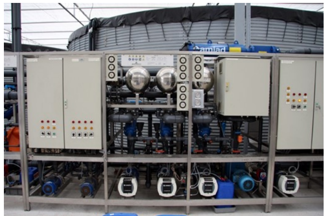
Foto 7. Sistema di disinfezione agli UV. (foto: V. Günther)
