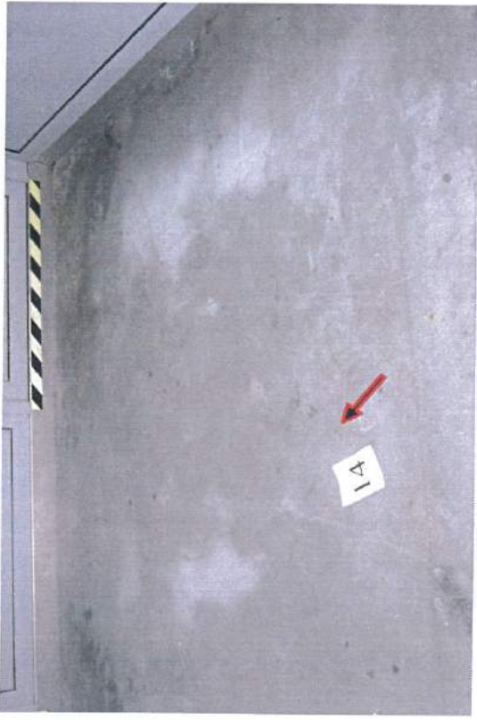
Foto 14: UBICAZIONE: pavimento accesso gradinate – terrazzo 1°P DIFETTO: fessura
