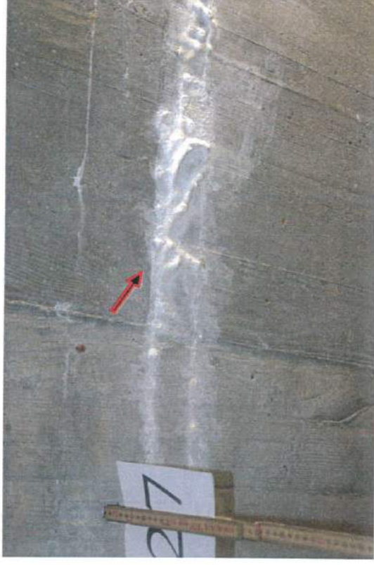
Foto 27: UBICAZIONE: soffitto spogliatoi – locale doccia (PT) DIFETTO: presenza di salnitro
