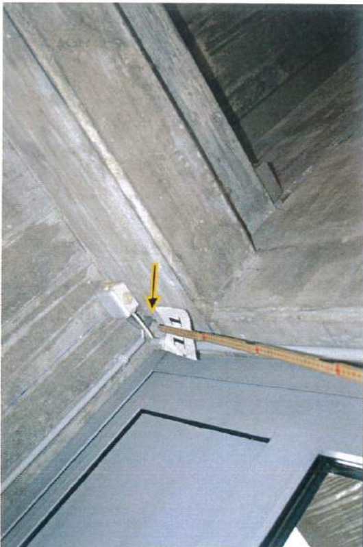
Foto 11: UBICAZIONE: zona accesso gradinate da terrazzo 1°p DIFETTO: mancanza di copiferro Esecuzione: A REGIA.
