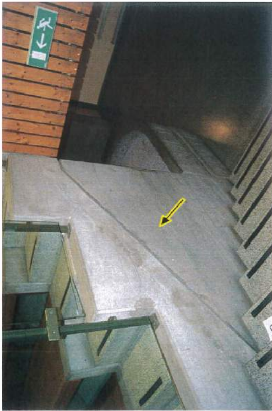
Foto 15: UBICAZIONE: scala accesso gradinate DIFETTO: fessura
