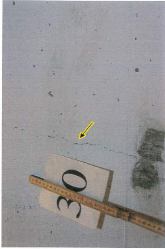
Foto 30: UBICAZIONE: parete retro palestra (P-1) DIFETTO: fessura Esecuzione: a REGIA
