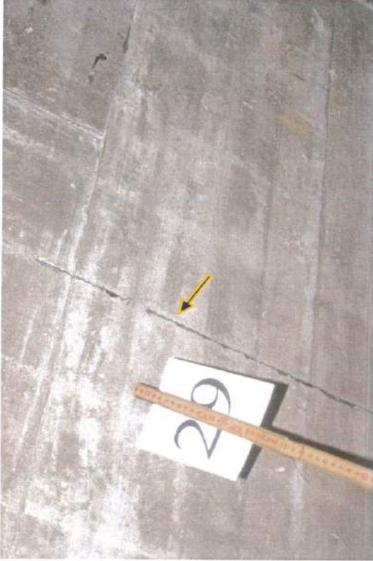
Foto 29: UBICAZIONE: scala PT – P-1 DIFETTO: scarso copriferro
