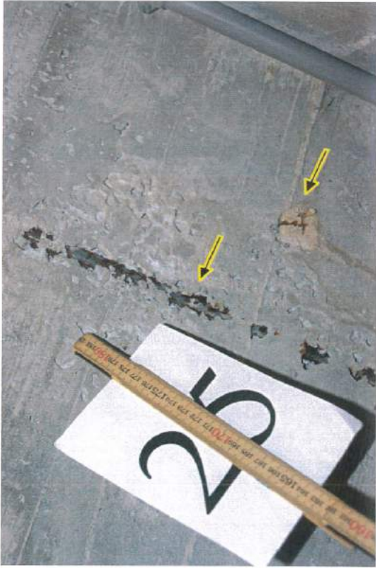
Foto 25: UBICAZIONE: locale tecnico (PT) DIFETTO: scarso copriferro Esecuzione: a REGIA
