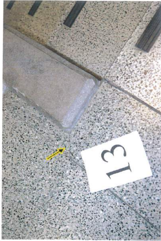
Foto 13: UBICAZIONE: gradinate DIFETTO: fessura capillare Esecuzione: a REGIA
