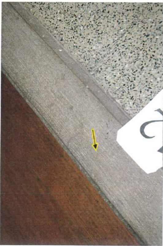
Foto 12: UBICAZIONE: gradinate DIFETTO: fessura capillare Esecuzione: a REGIA
