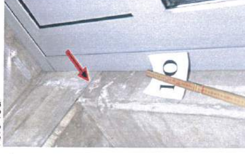
Foto 10: UBICAZIONE: zona accesso gradinate da terrazzo 1°P DIFETTO: fessura Esecuzione: a REGIA
