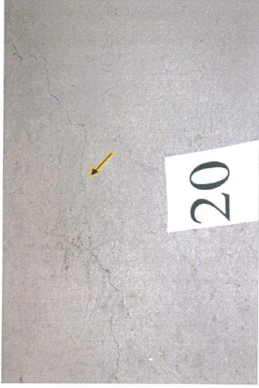
Foto 20: UBICAZIONE: zona sotto gradinate (PT) DIFETTO: fessura Esecuzione: a REGIA
