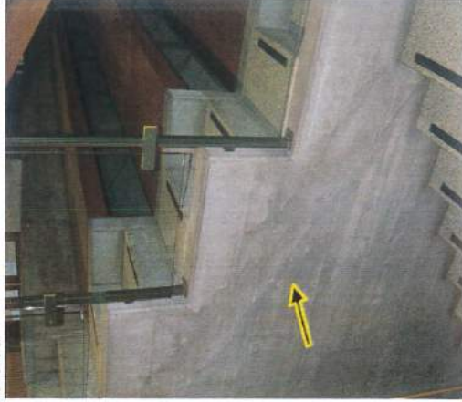
Foto 5: UBICAZIONE scala accesso gradinate DIFETTO: fessura
