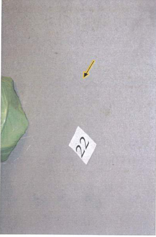
Foto 22: UBICAZIONE: zona sotto gradinate (PT) DIFETTO: fessura Esecuzione: a REGIA
