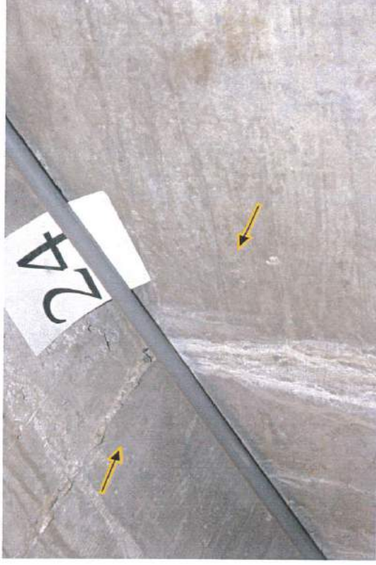
Foto 24: UBICAZIONE: zona sotto gradinate (PT) DIFETTO: macchie di umidità Esecuzione: a REGIA
