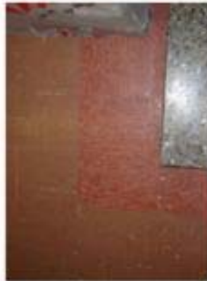
1 Rivestimenti non ammantati: superficie in questo caso l'amianto è inglobato in una matrice compatta.
