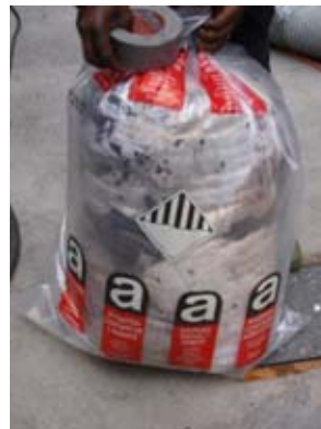
6 Sacco di plastica con la dicitura «Amianto»
