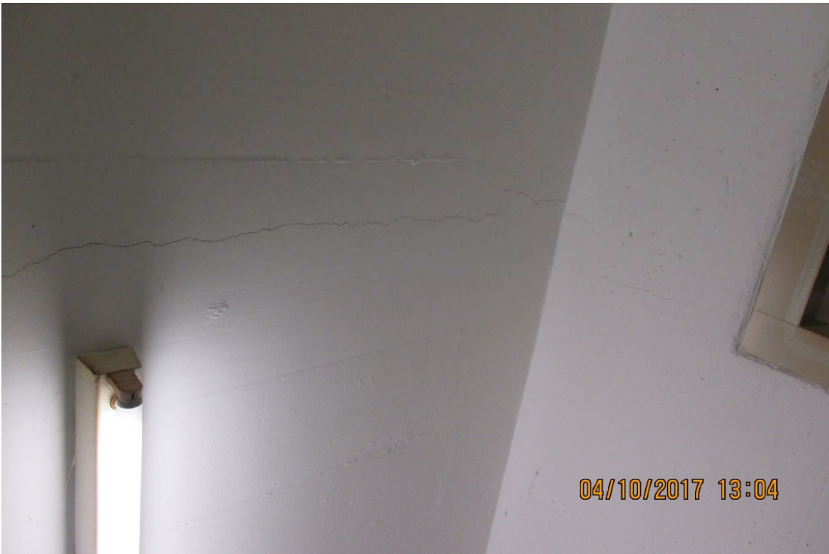
Foto 1 – Fessura sotto soletta da muro a muro nel piano interrato
