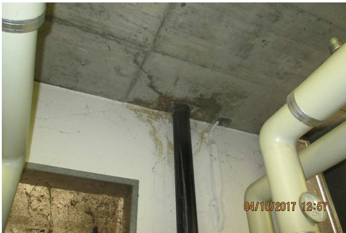
Foto 3 – Perdita di acqua in corrispondenza del tubo al piano interrato
