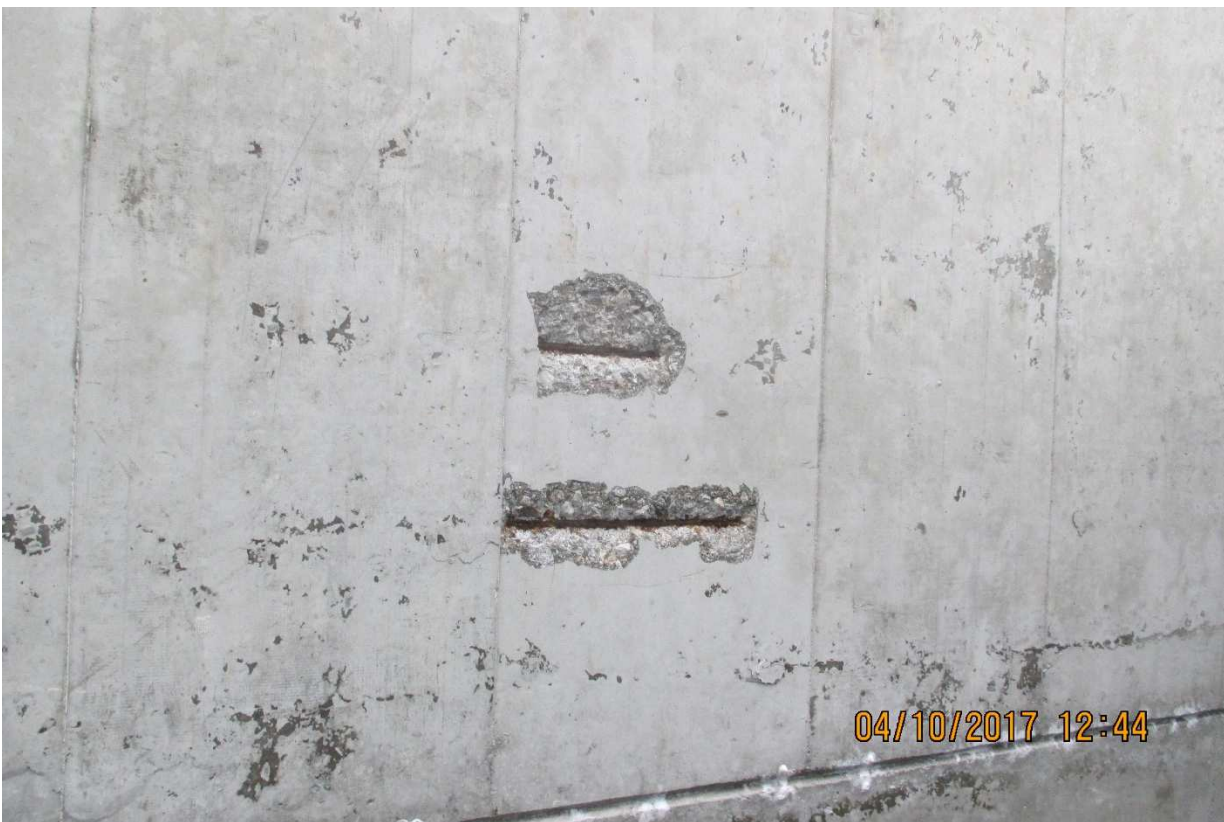
Foto 7 – Stacchi del calcestruzzo e ferri visibili e corrosi sul soffitto del portico
