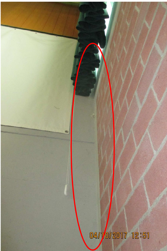
Foto 2 – Fessura su giunto in palestra
