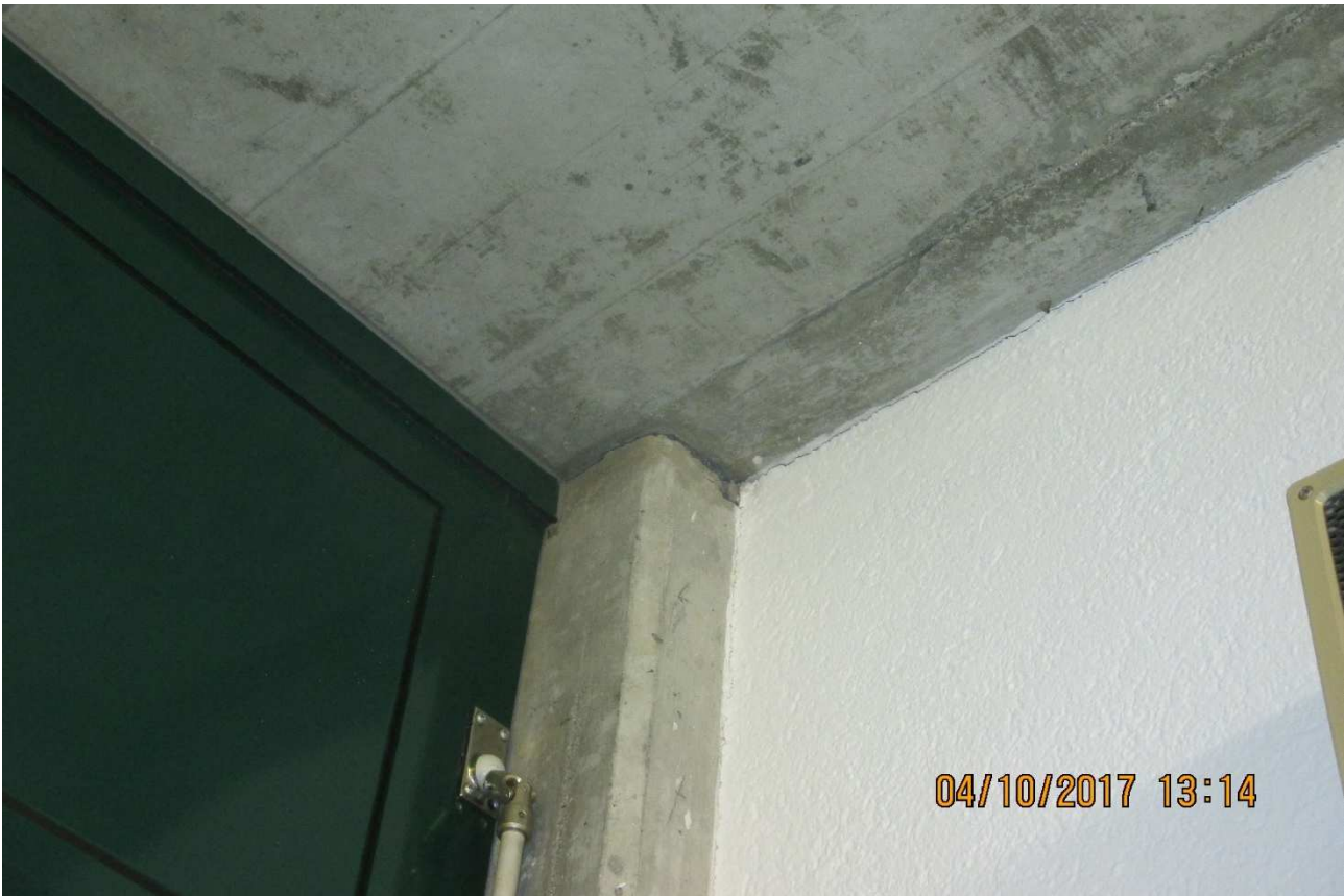
Foto 8 – Fessure nella soletta del tetto in corrispondenza degli angoli / 2°P
