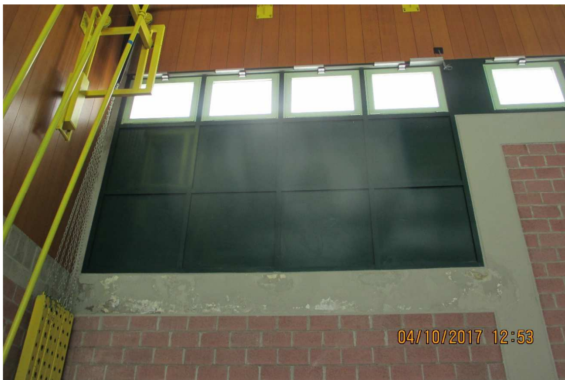
Foto 4 – Scrostamento parete della palestra a causa di un'infiltrazione d'acqua proveniente dal piazzale esterno
