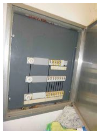
Tutto l'edificio - Materiale 32: quadri elettrici - contiene amianto
