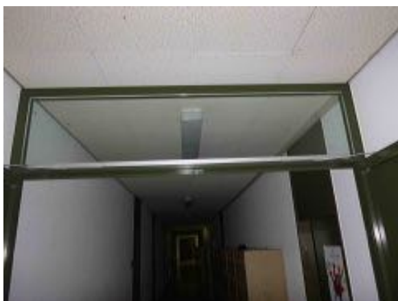
Tutto l'edificio - Materiale 35: mastice porte tagliafuoco - posate nel 2007
