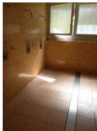
Doccia M e F - Materiale 5: colla dietro piastrelle pareti - contiene amianto; Materiale 6: colla sotto piastrelle pavimento - non contiene amianto
