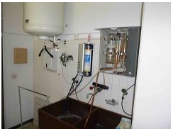
Tutto l'edificio - Materiale 33: boiler - può contenere amianto
