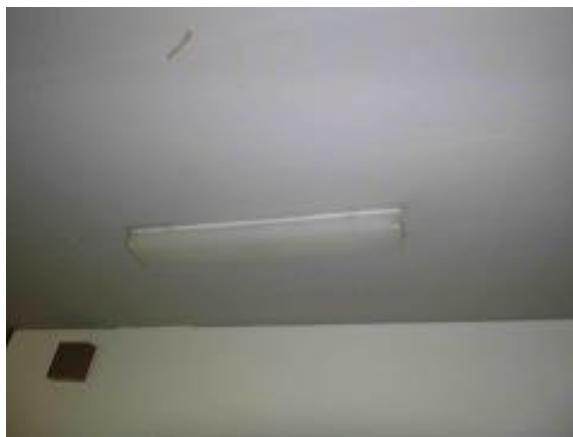
Tutto l'edificio - Materiale 34: cartoncino sotto involucro lampade - contiene amianto
