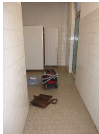
Bagno M e F - Materiale 1: colla sotto piastrelle pavimento - non contiene amianto, Materiale 2: colla dietro piastrelle bianche pareti - contiene amianto
