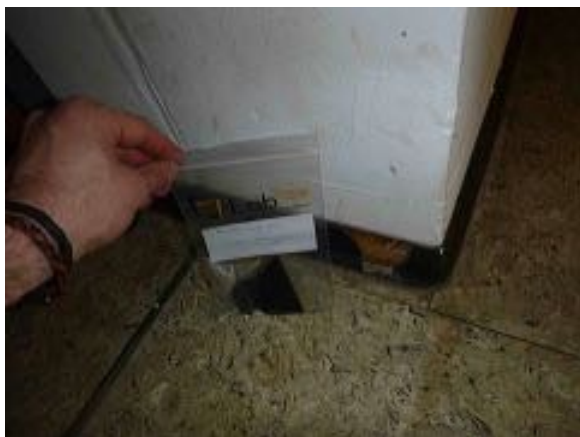
Materiale PCB nr. 2: zoccolino nero tra pavimento e parete - non contiene PCB
