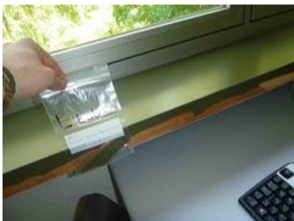
Aula - Materiale 25: rivestimento davanzale - contiene amianto
