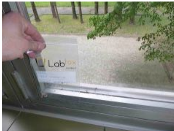
Intero edificio - Materiale 24: mastice finestre - contiene amianto
