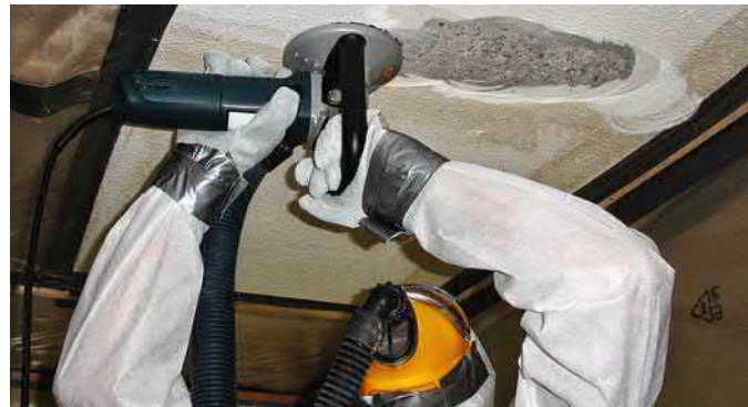
Rimozione solo da parte di ditte specializzate in bonifiche da amianto riconosciute
