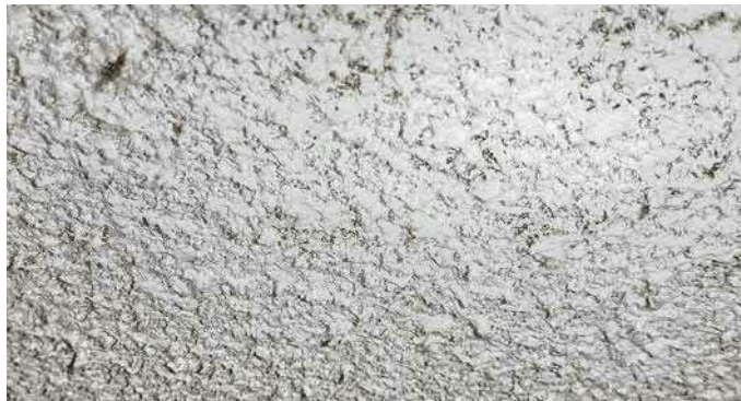
Intonaco acustico contenente amianto
