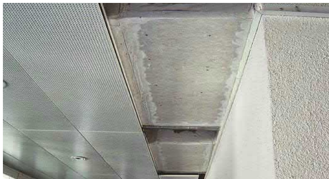
Pannelli per soffitti contenenti amianto
