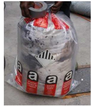
6 Sacco di plastica con la dicitura «Amianto»
