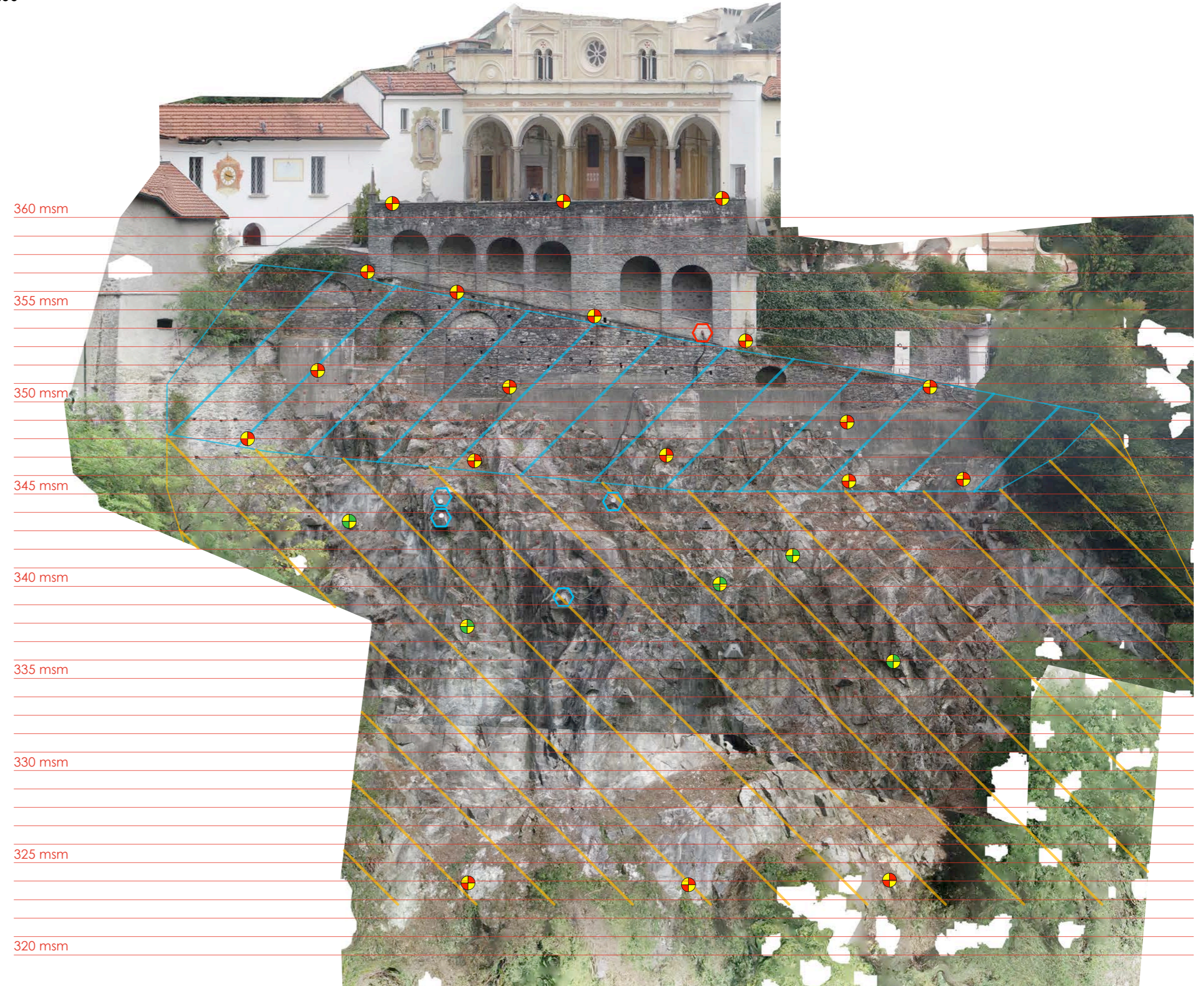
Ortofoto parete rocciosa sud Area di spurgo e concetto di monitoraggio Scala 1:200
