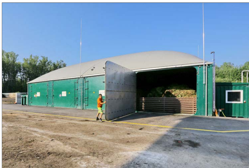
Figura 3.8 – Esempio di impianto di compostaggio affiancato alla fermentazione (ditta Bekon GmbH, Unterföhring; in basso impianto Bekon Mini, Galmiz).
