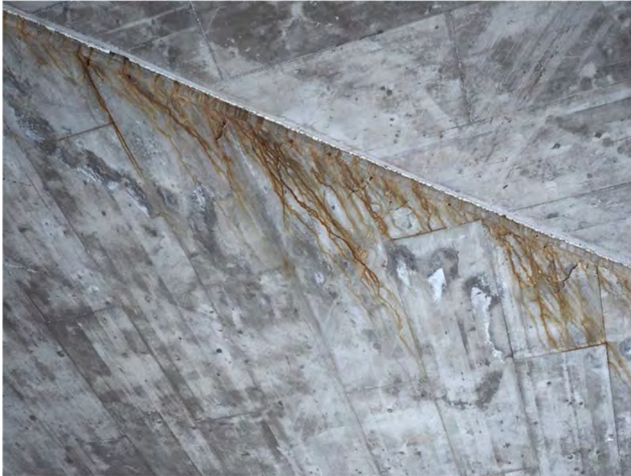
66. Soletta, dettaglio giunto zona A-zona B. Fuoriuscita di acqua e salnitro
