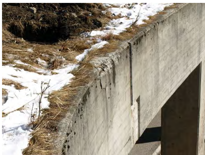
77. Cordolo danneggiato e ferri scoperti
