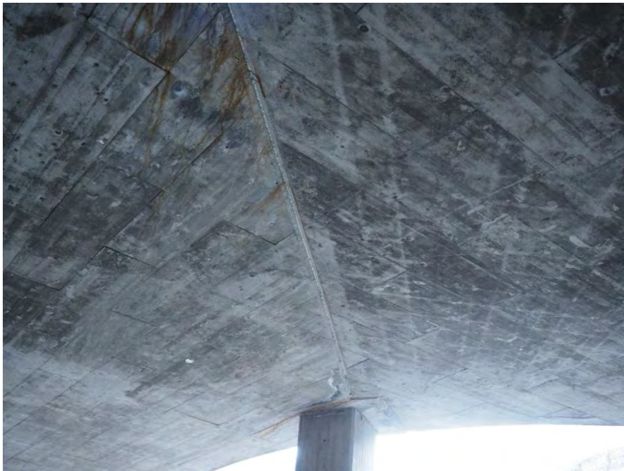
67. Soletta, dettaglio giunto e fuoriuscita di acqua e salnitro
