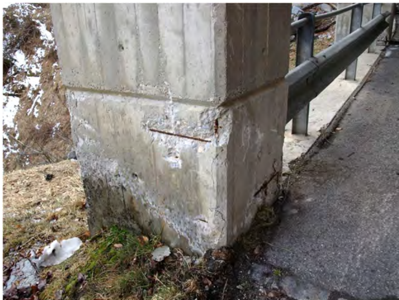
43. Pilastro P6, basamento e difetti
