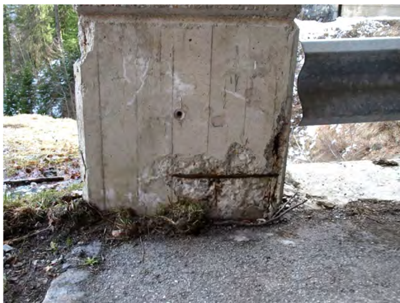
42. Pilastro P6, basamento e difetti
