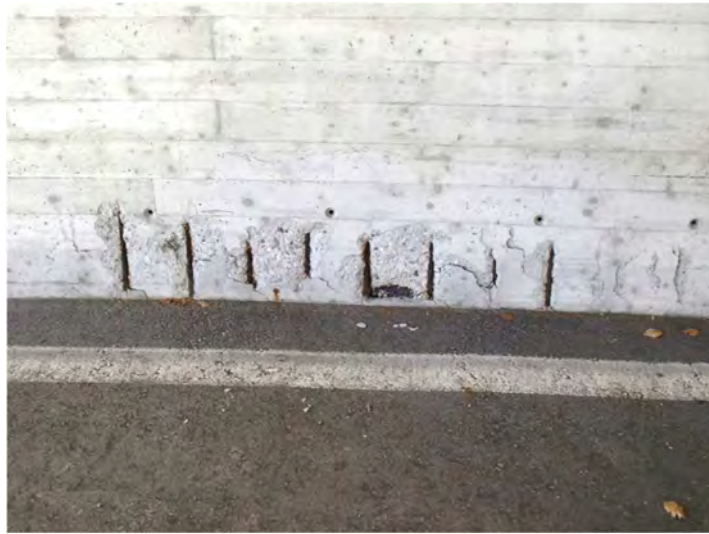
9. Dettaglio ferri scoperti
