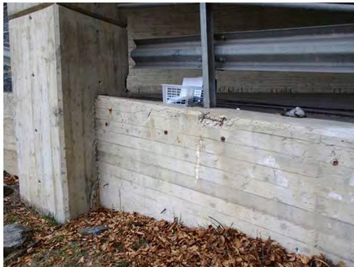
48. Trave T2, dettaglio difetto
