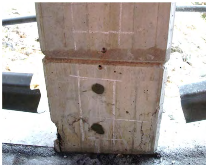
30. Pilastro P2, difetti nella parte bassa e carotaggi
