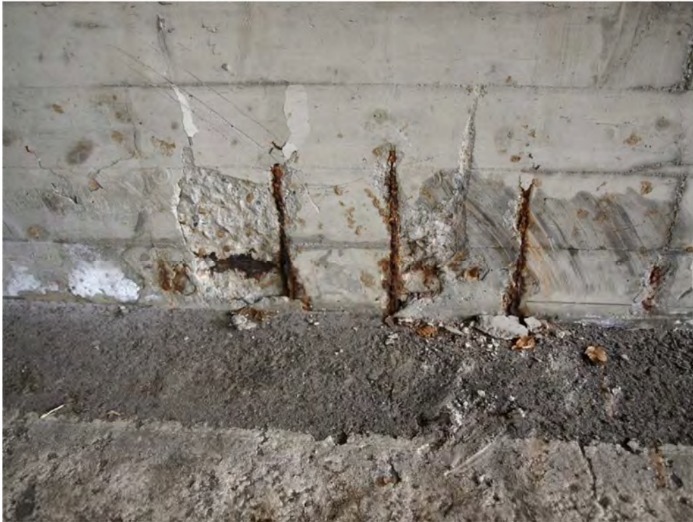
24. Dettaglio ferri scoperti e distacco del copriferro
