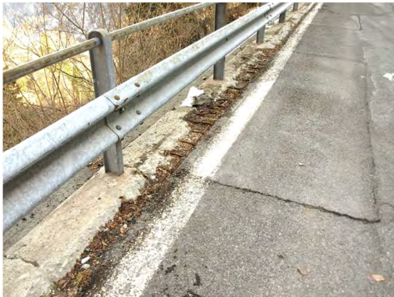
92. Cordolo strada lato Campo VM, ferri scoperti
