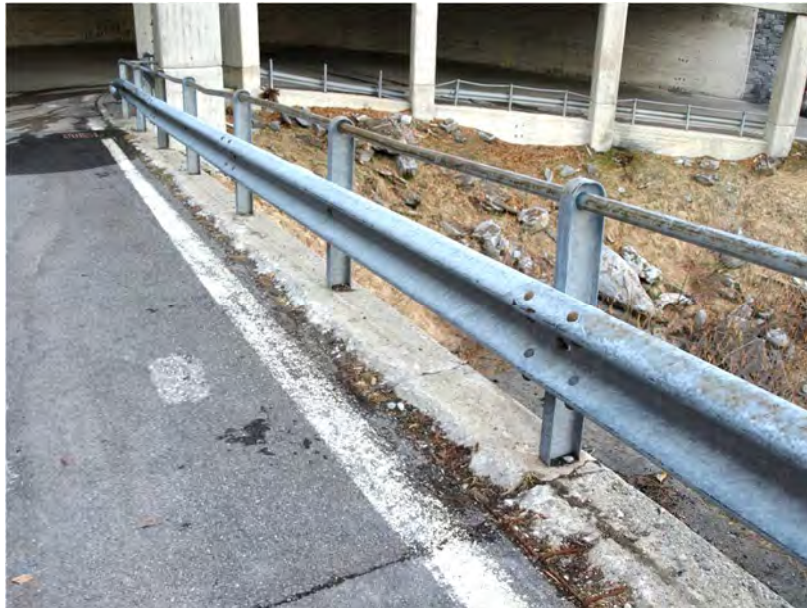
91. Cordolo strada lato Campo VM, difetti
