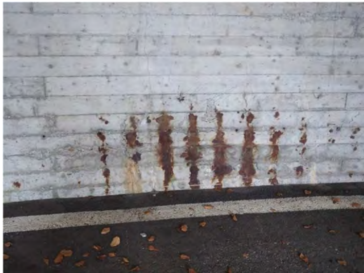
18. Dettaglio ferri scoperti
