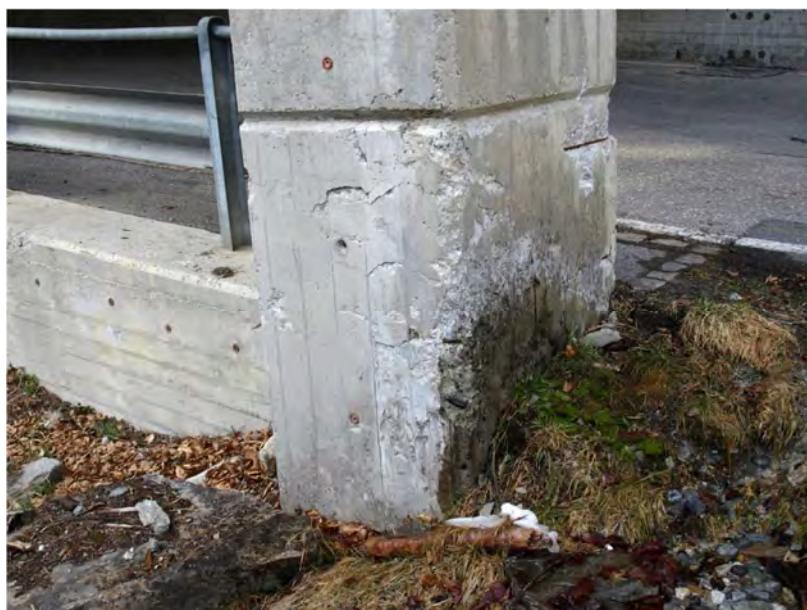
44. Pilastro P6, basamento e difetti
