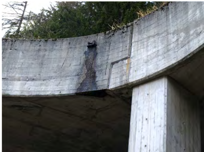
64. Soletta, giunto e scolo acqua lato Campo VM
