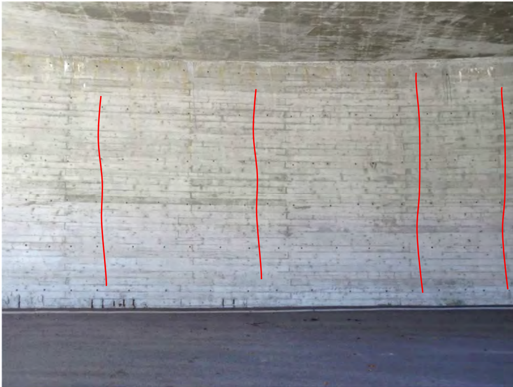
7. Continuazione del muro (zona A), diversi difetti e fessure
