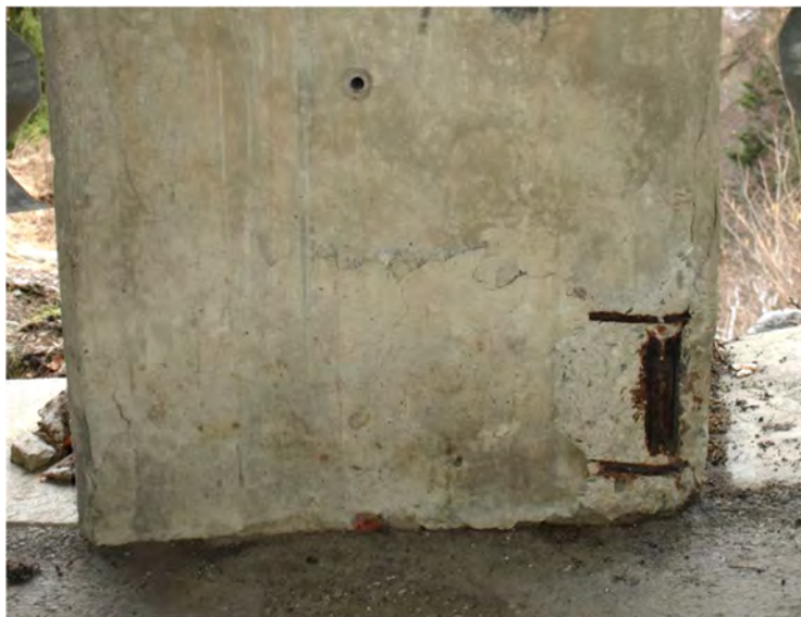
33. Pilastro P3, veduta interna e difetti
