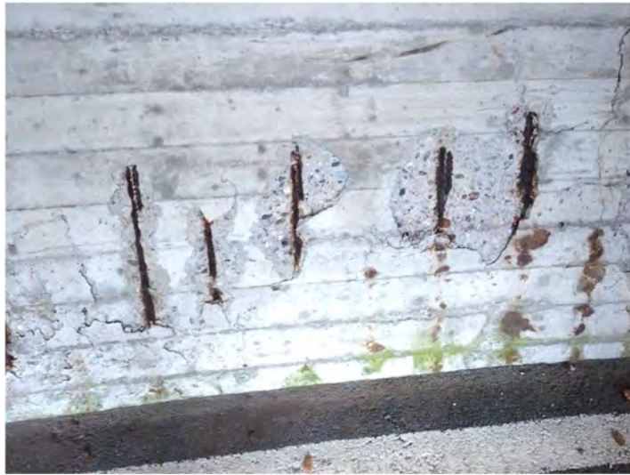
17. Dettaglio ferri scoperti
