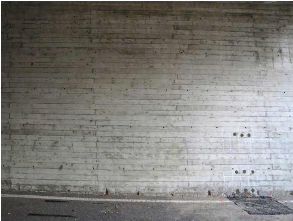
22. Muro all'entrata del portale di Cerentino (zona C), alcuni ferri scoperti
