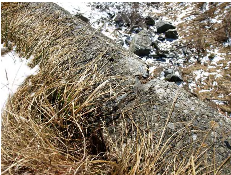
74. Dettaglio giunto nel cordolo lato Campo VM
