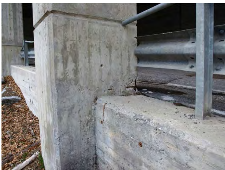
39. Pilastro P5, collegamento con trave e difetti
