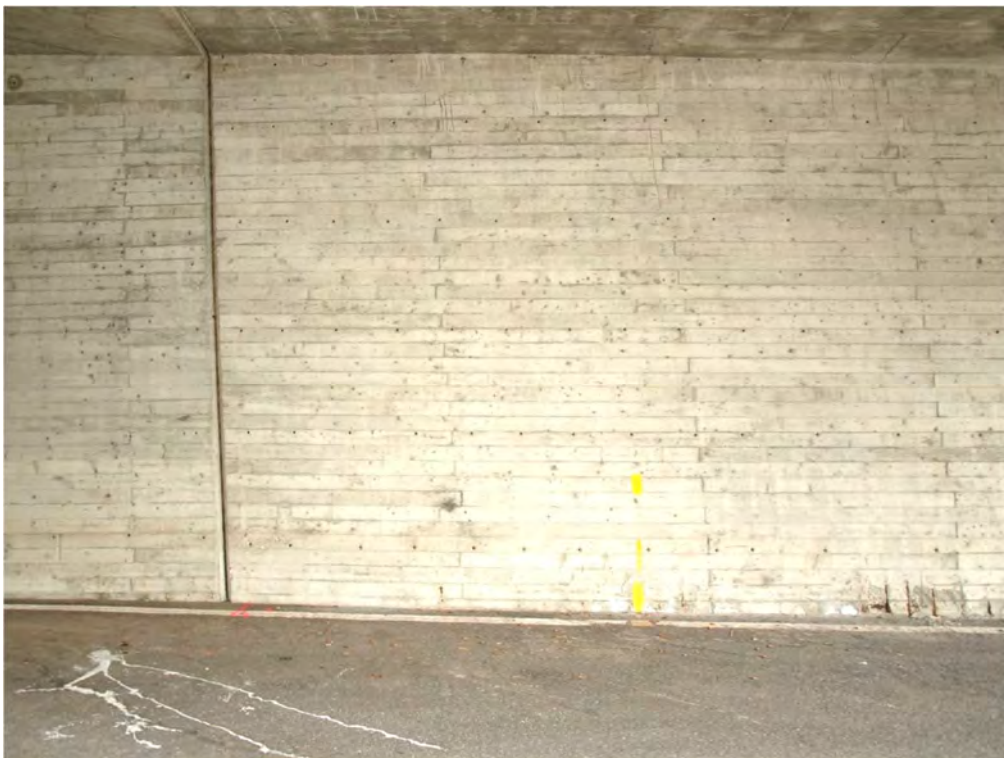
21. Muro zona C, diversi ferri scoperti in basso
