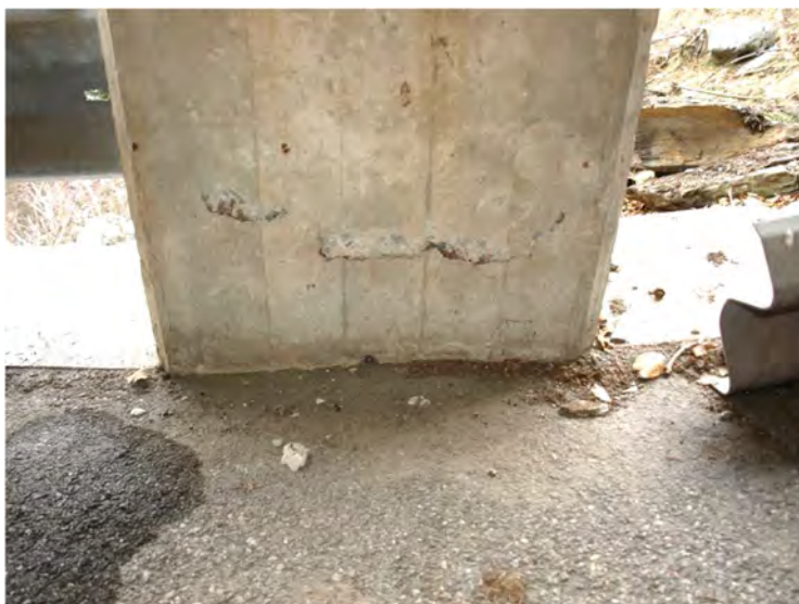
36. Pilastro P4, veduta interna e difetti
