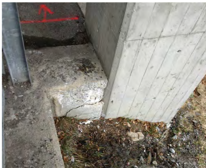
27. Dettaglio calcestruzzo deteriorato
