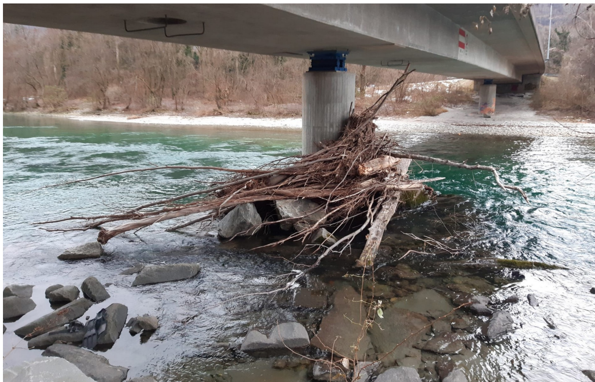
Fig. 8: Ispezione subacquea del 23 dicembre 2021 con deposito di legname flottante.
