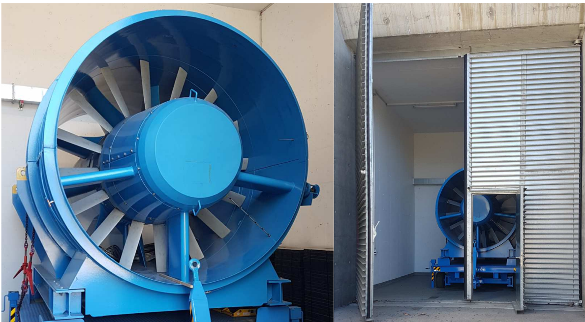
Figura 3: Immagini ventilatore HUWD21-ND53 di riserva presso portale Vedeggio
