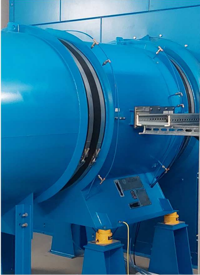
Figura 9: Ventilatore Zitron FUWD12-ND45 posizionati ai due portali del cunicolo di sicurezza
