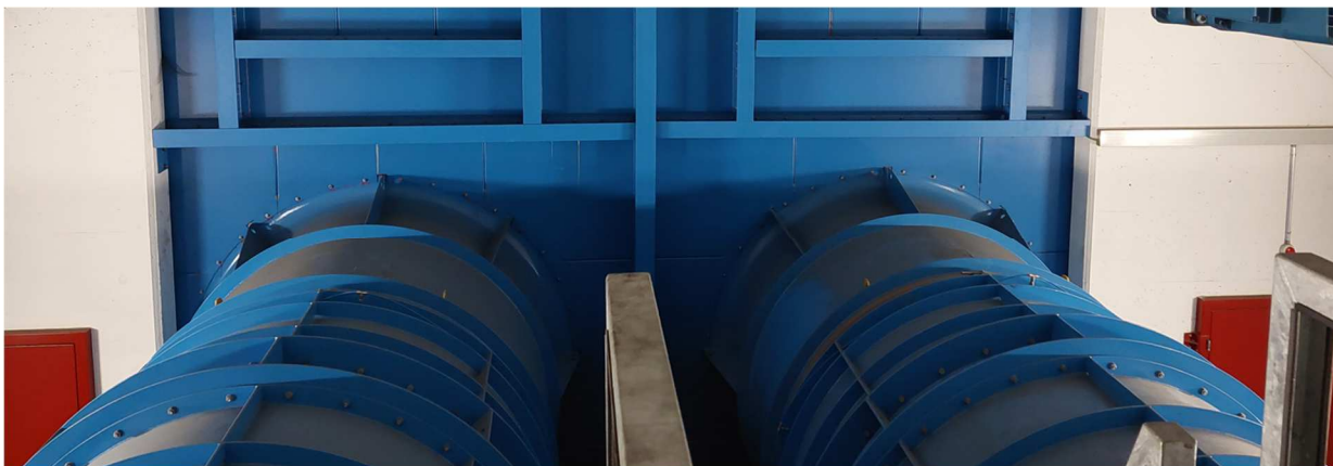
Figura 7: Ventilatori HUWD21-ND53 in parallelo al piede del pozzo intermedio
