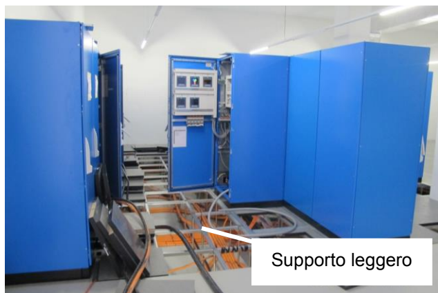
Rapp. 17: Armadi elettrici su pavimento tecnico
