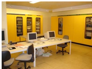
Zona 30 : Locale tecnico
