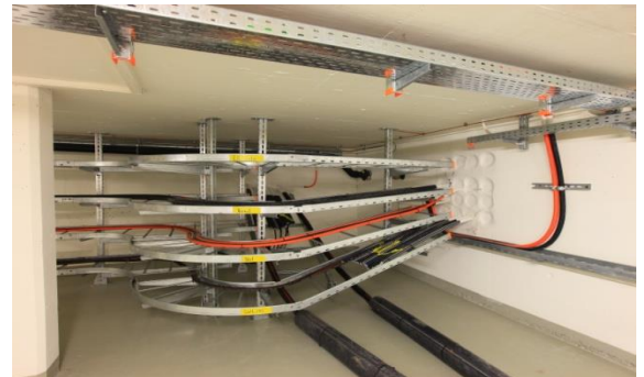
Cunicolo tecniche con canalina per cavi
