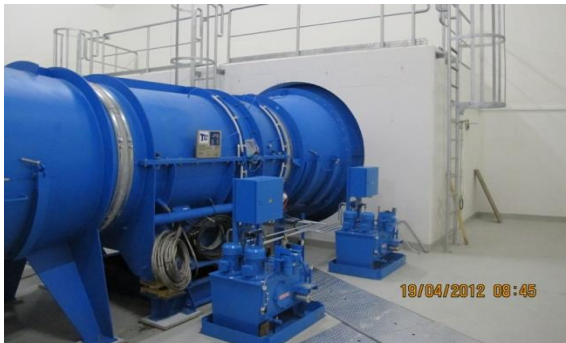
Centrale di ventilazione (interno del ventilatore: categoria della corrosione C5)
