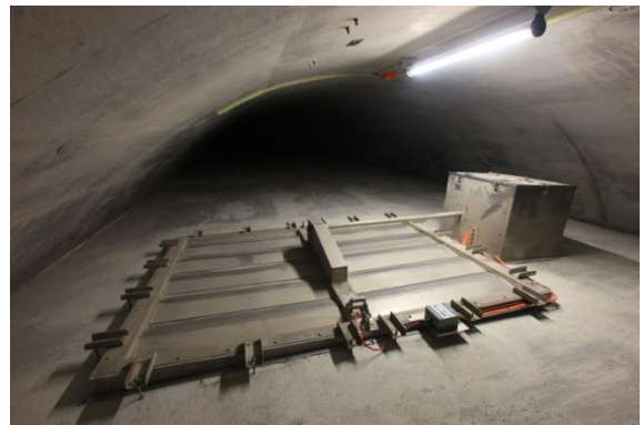
Canale di aria viziata con cappa d'aspirazione
