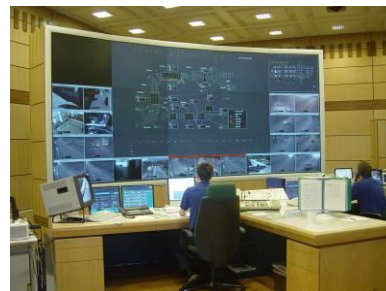
Zona 40 : Centrale di comando
