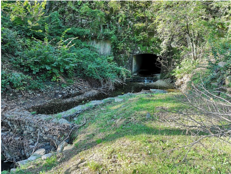
Figura 51: braccio del Leguana a valle della protezione civile con interruzioni artificiali
