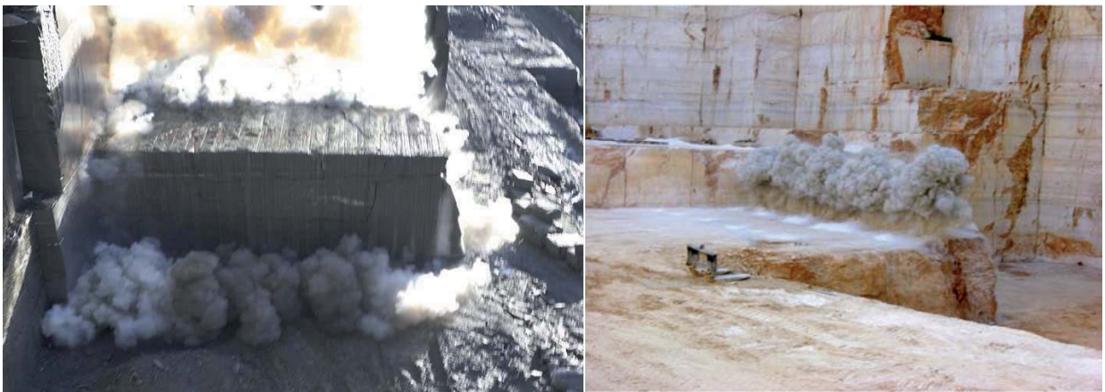
Immagine 5: Utilizzo di miccia detonante per la riquadratura di un blocco e per la sezionatura di una fetta verticale
