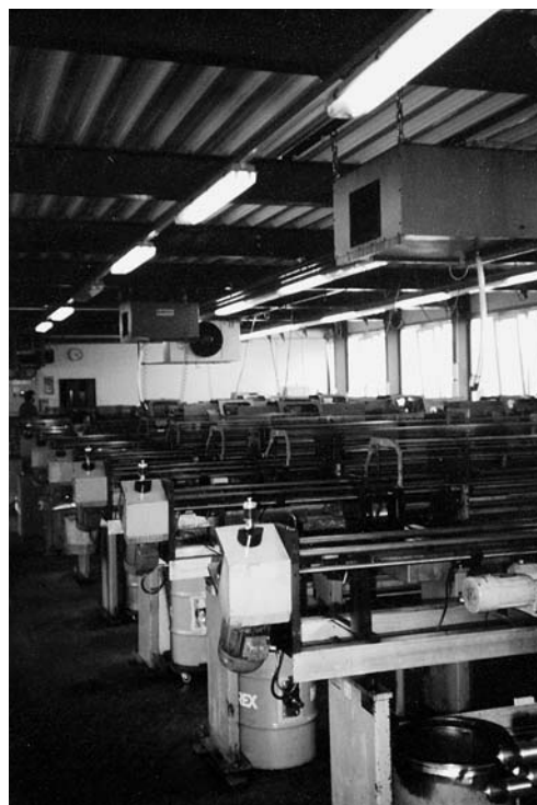
Officina di décolletage provvista di ventilazione artificiale. Una volta filtrata, l'aria viene riciclata nella zona di lavoro.
