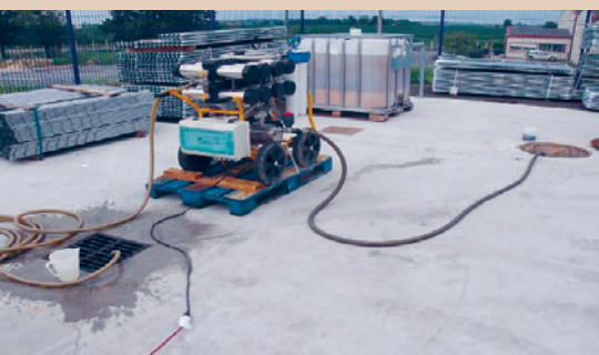
Un impianto di ultrafiltrazione permette di trattare grandi quantità di acqua, CCD
