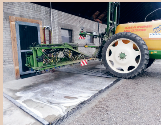
Piattaforma coperta per il lavaggio, munita di una griglia di drenaggio, Th. Haller
