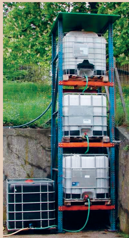
Il sistema di biofiltrazione è interessante se l'acqua ottenuta al termine è poi riutilizzata per l'irrigazione, AGRIDEA
