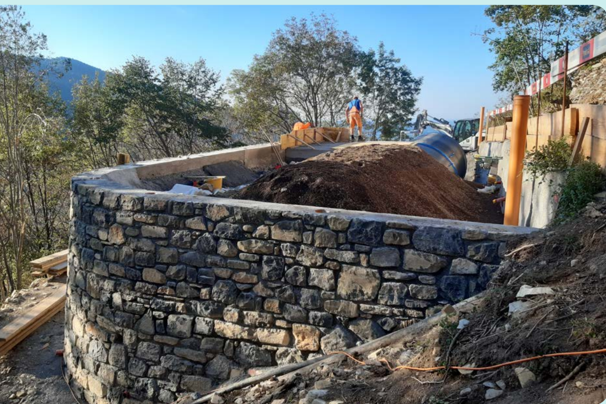
Figura 35. Lavori di costruzione del nuovo serbatoio dell'acqua potabile di Monte (terminati a fine ottobre 2022)
