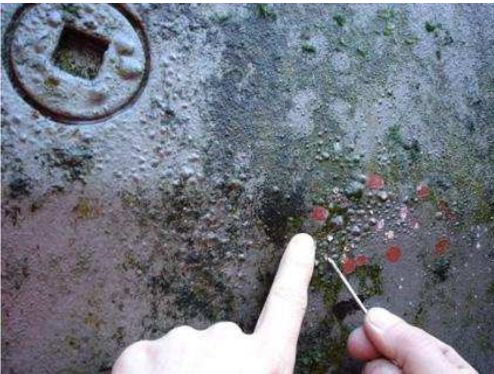
Foto 12: Difetti del rivestimento protettivo della ventola
