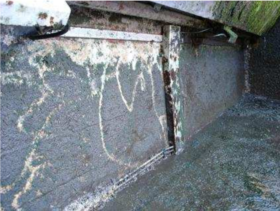
Foto 5: Tubazioni dell'impianto di grassaggio delle cerniere
