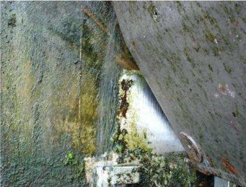
Foto 11: Perdita dal bordo laterale destro della paratoia
