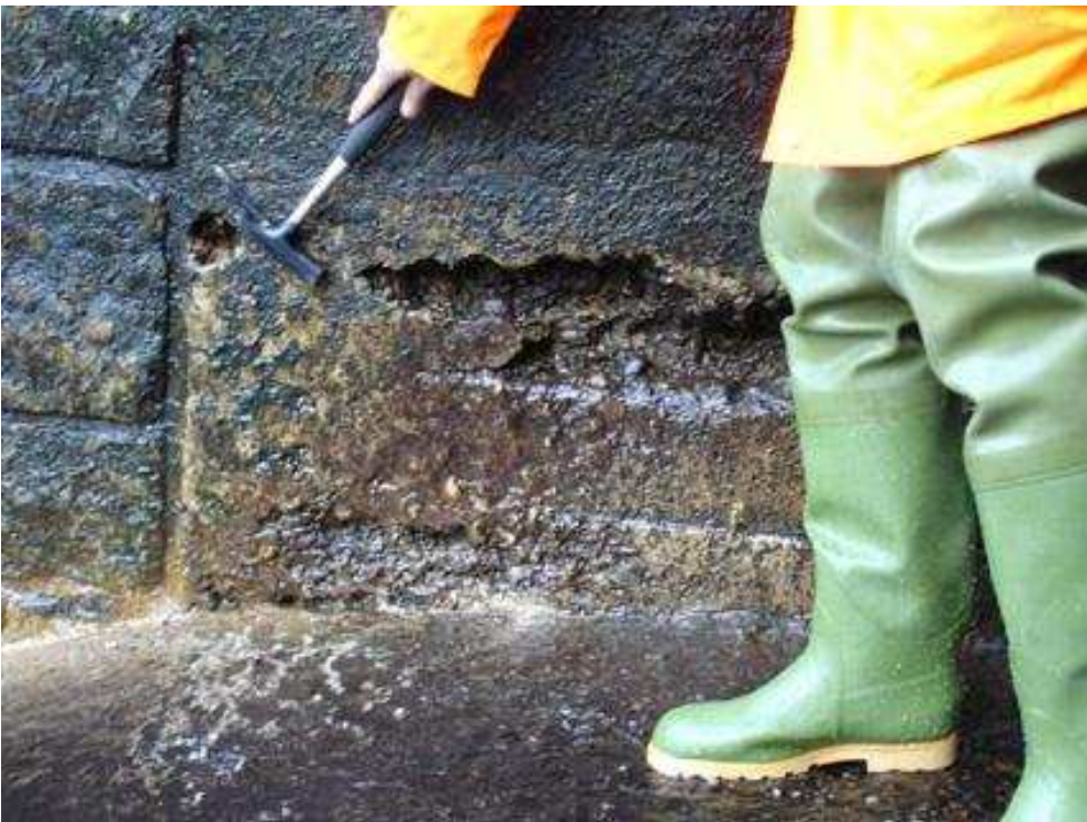
Foto 10: Lesione del calcestruzzo al piede del muro d'argine
