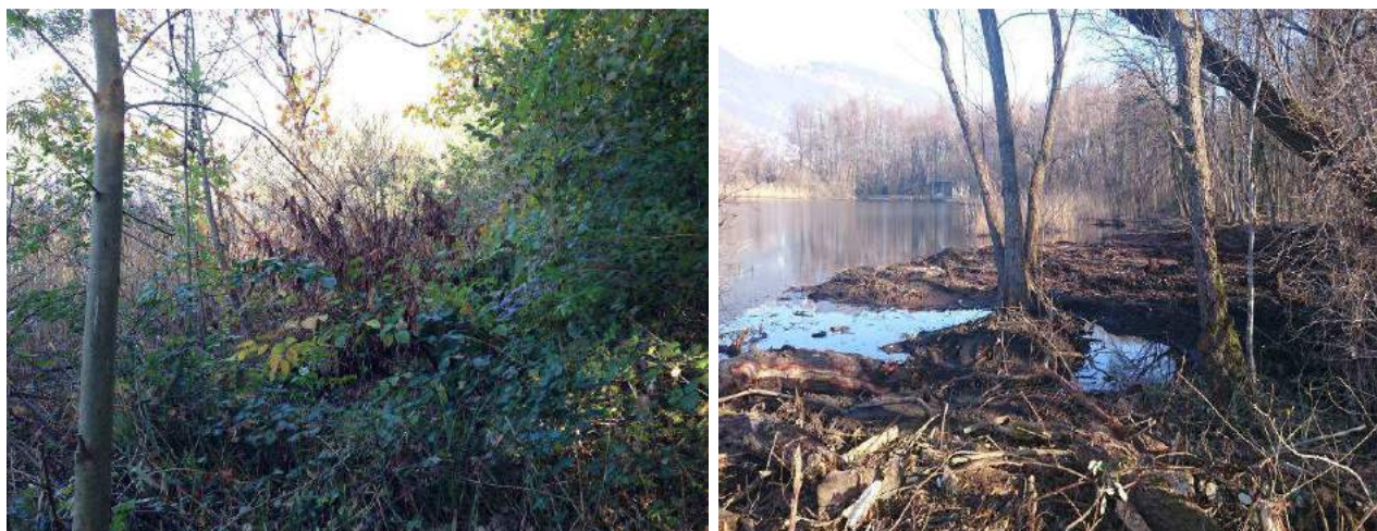
Figure 91 e 92: riva lago prima degli interventi (sinistra) e riva lago dopo gli interventi (destra)
