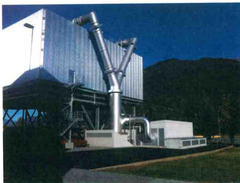
Stazione di pompaggio
