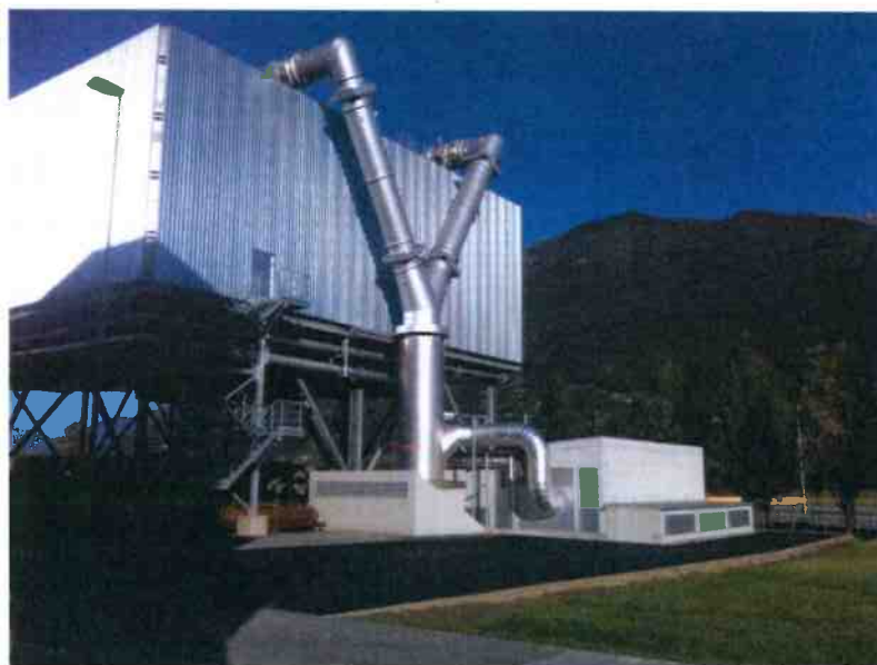
Stazione di pompaggio
