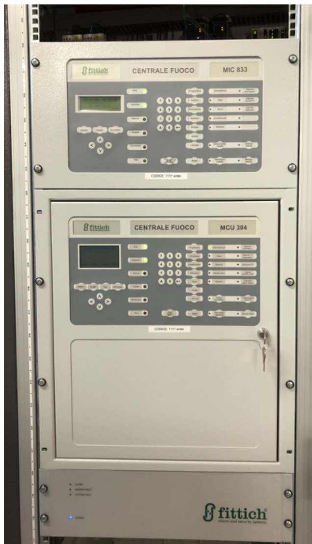
Centrale locale tecnici e sensore lineare
