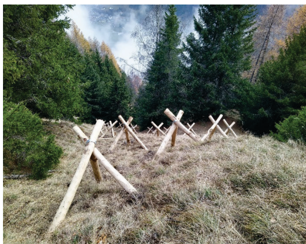
Fig. 4: Cavalletti treppiedi con un'altezza utile H_k= 1.5 m
