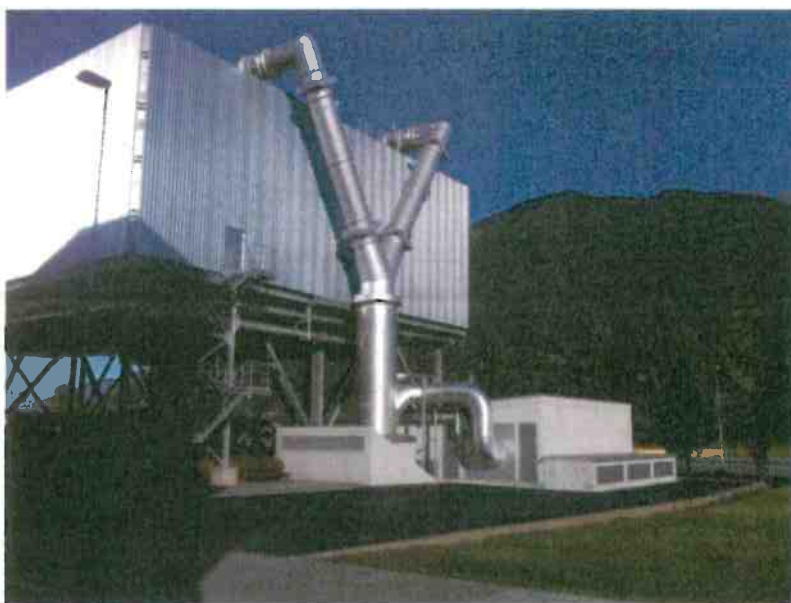
Stazione di pompaggio
